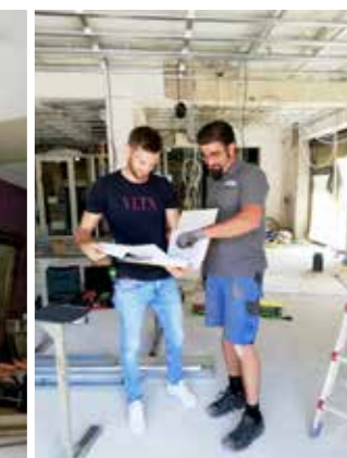
Der Bauherr auf der Baustelle: Apotheken-Chef Peter Gall ließ den Verkaufsraum komplett entkernen.
